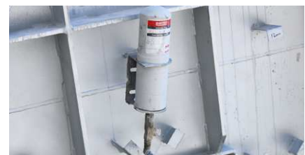
Bearing lubrication on a fan
