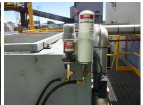
Fin fan lubrication
